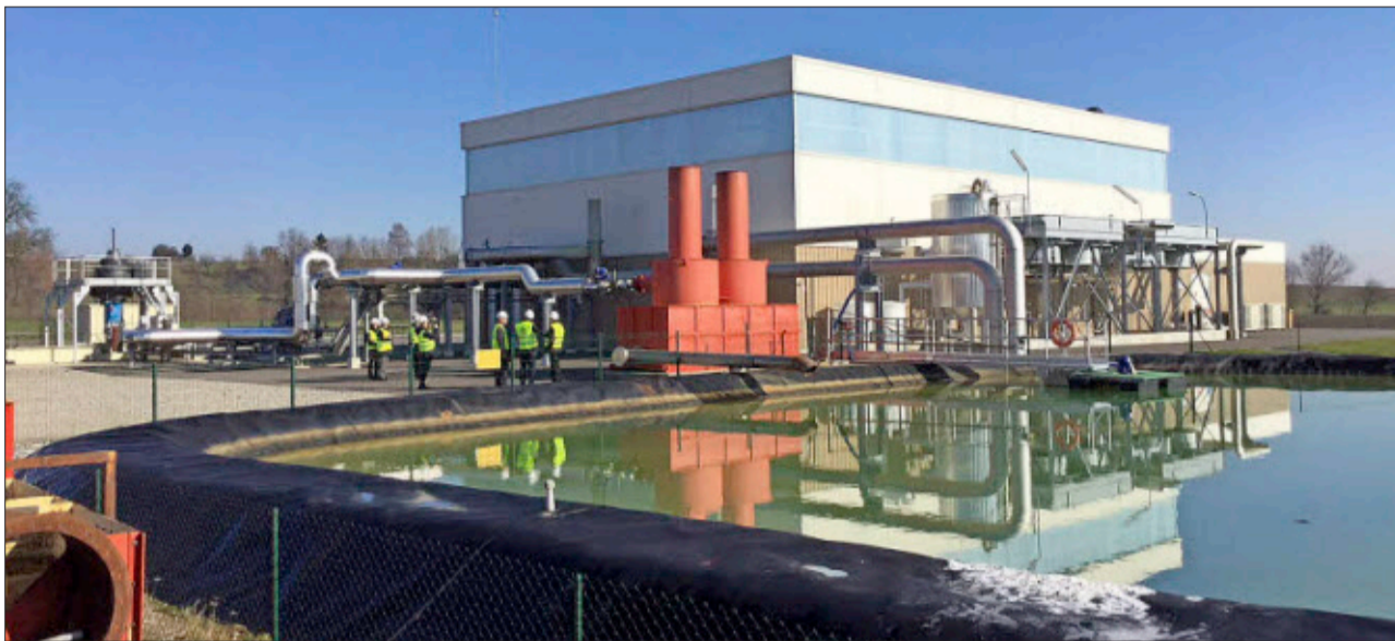
Die Geothermie-Anlage im elsässischen Rittershoffen
